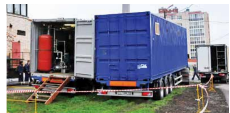
Для отопления детского сада теплоэнергетики подключили передвижную блок-модульную котельную.
