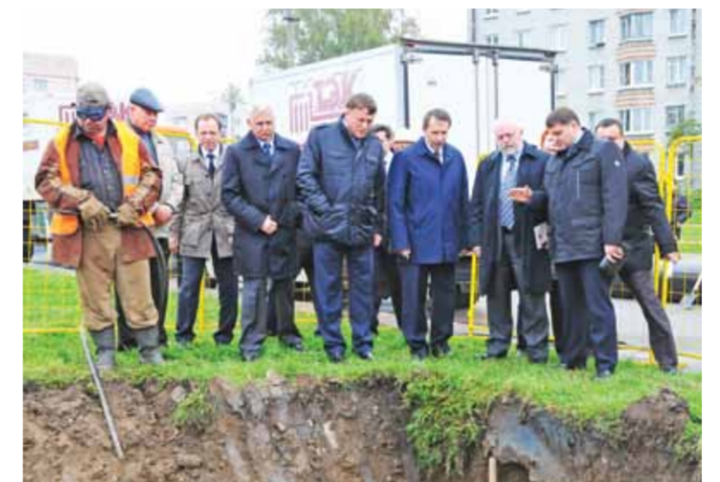
Место технологического повреждения тепломагистрали.
